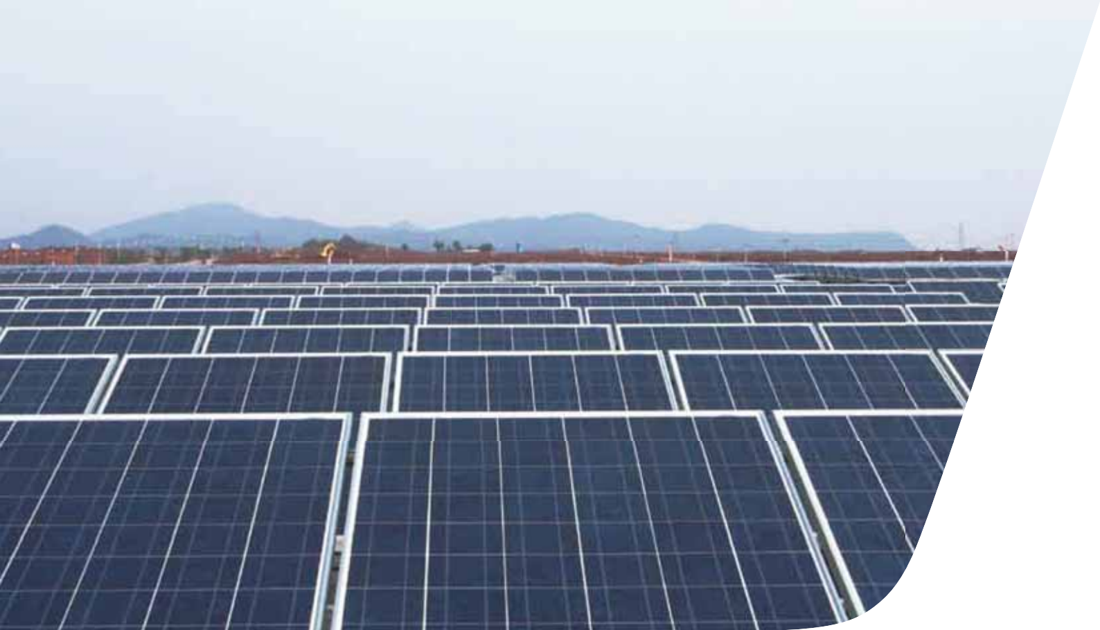
Fotos mit freundlicher Genehmigung von: LDK Solar Power Tech./ Standort: Xin Yu, China/ Systemgröße: 2MW/ LDK Fabrikdachinstallation
